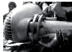
Mise à la terre de la turbine sur le mât
