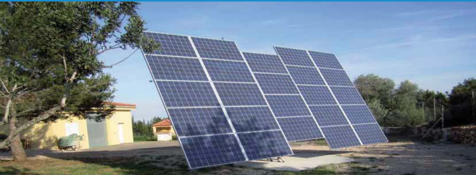
Calig, Espagne : Maison connectée au réseau avec Quattro et Convertisseur de réseau BlueSolar
